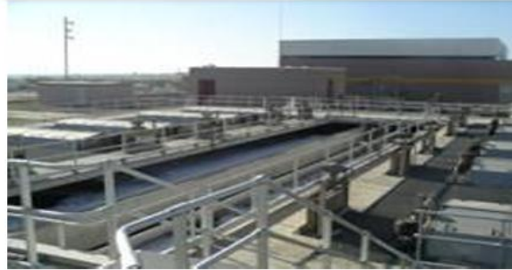
Microfiltració a 10µm
