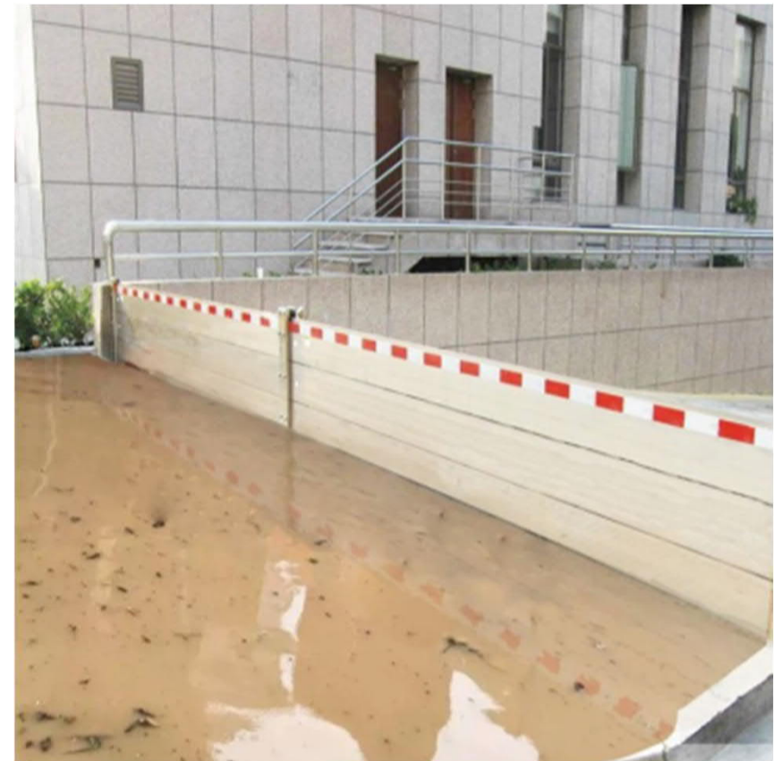
Barrera anti-inundació a l'entrada d'un parking
